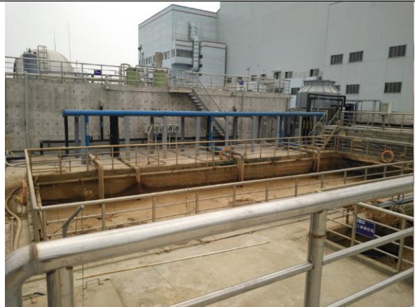
渗滤液处理站
