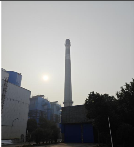
二期工程烟气处理设施及排气筒
