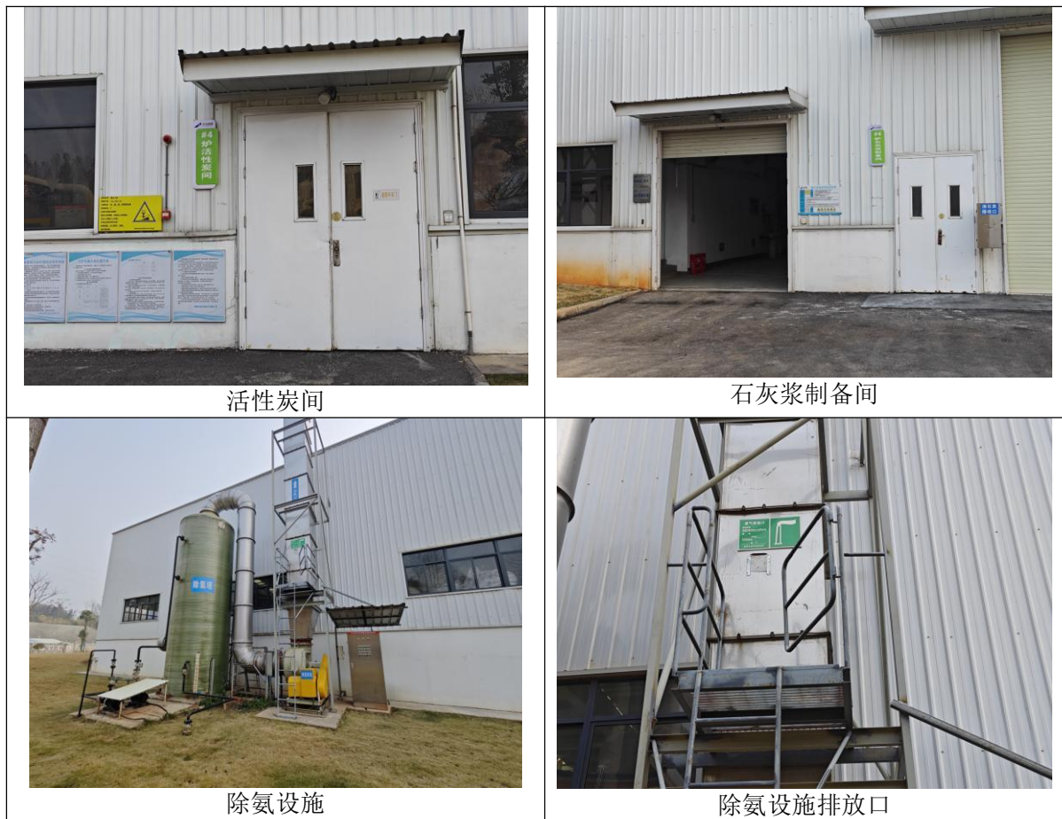
图 3.6-5 现有工程废气处理系统现场图片
