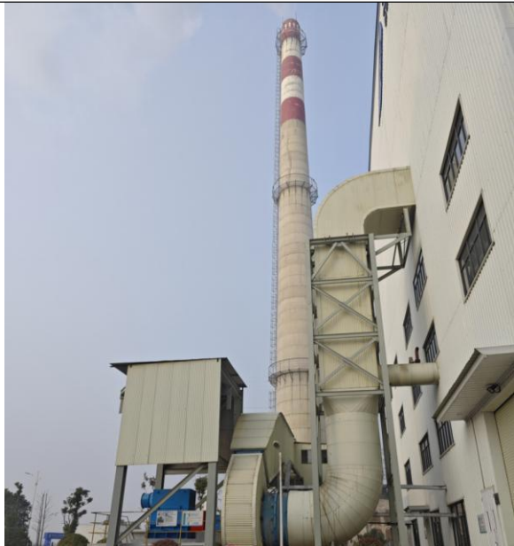
三期工程烟气处理设施及排气筒
